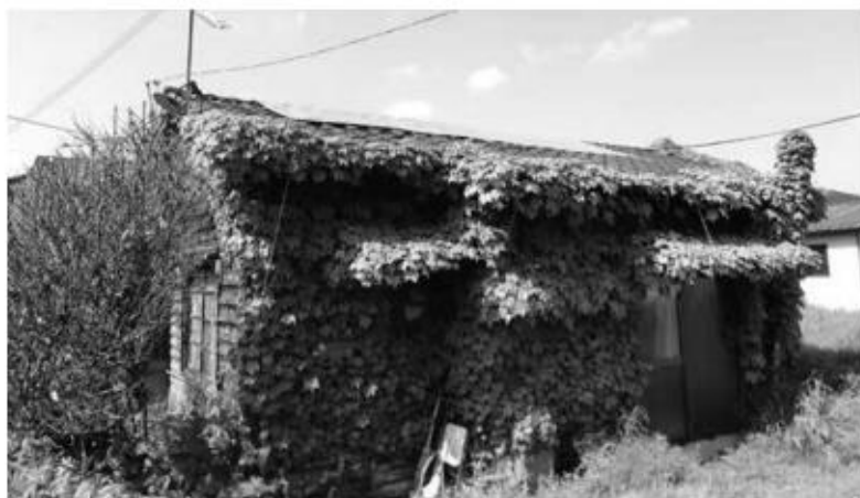
老朽化した町営住宅（辺田見団地）
