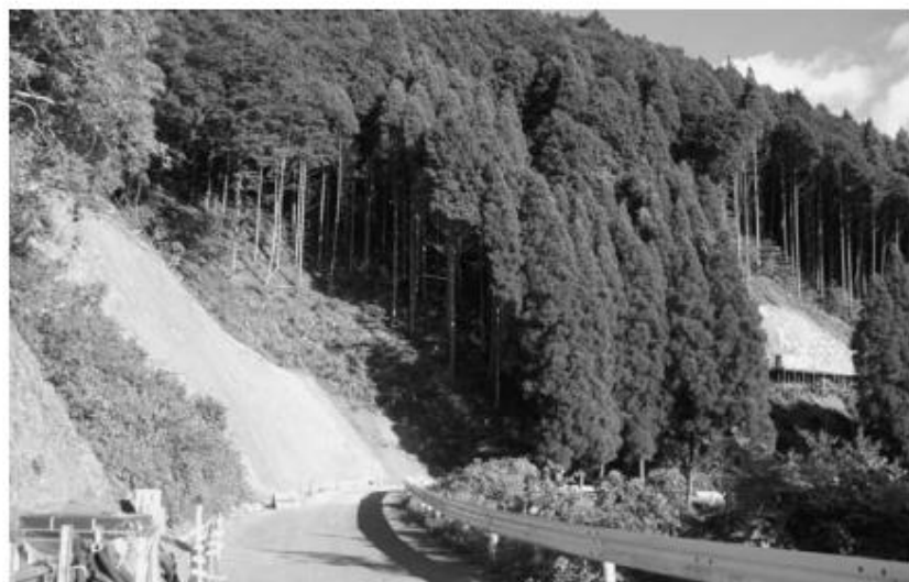
中山間地区では、がけ崩れの危険性がある急傾斜地に面した生活道路が多数ある。 横野水越線 8月26日
